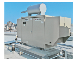
非常用発電機(参考写真)
