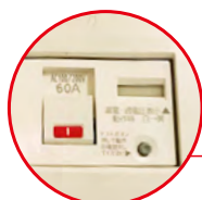
漏電遮断器 (主幹ブレーカー)
