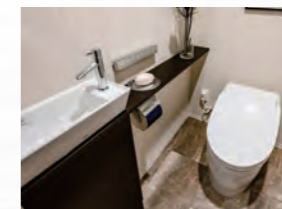
節水&節電機能付便器 (ウォシュレット一体型) +手洗いカウンター
