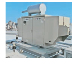
非常用発電機(参考写真)
