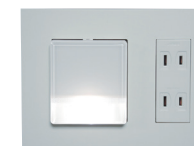
足元停電灯 (参考写真)
