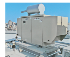
非常用発電機(参考写真)
