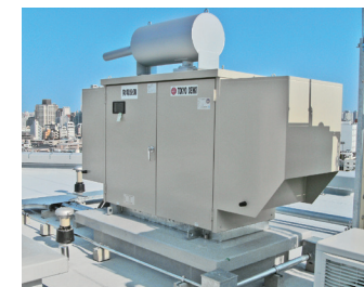
非常用発電機（参考写真）
