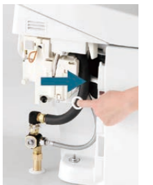
停電時の専有部大便器の洗浄方法
