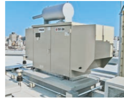
非常用発電機(参考写真)
