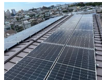
【設置した太陽光パネルの一部】
